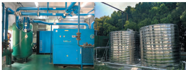
逆变器压缩机（200kW）1台
